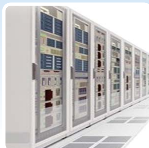
データセンター制御 システム
